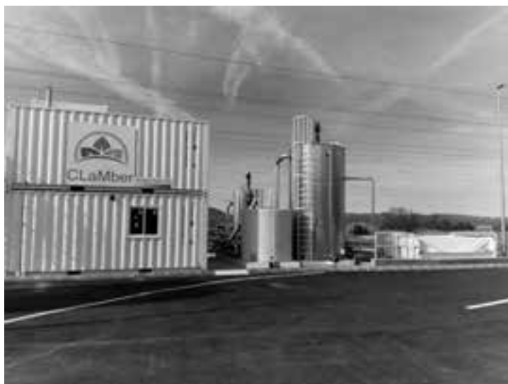
Figura 5. Unidad de digestión anaerobia
