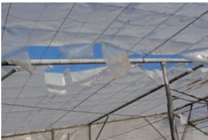
Figura 8. Roturas en el plástico de cubierta al utilizar sublimadores sin protección
