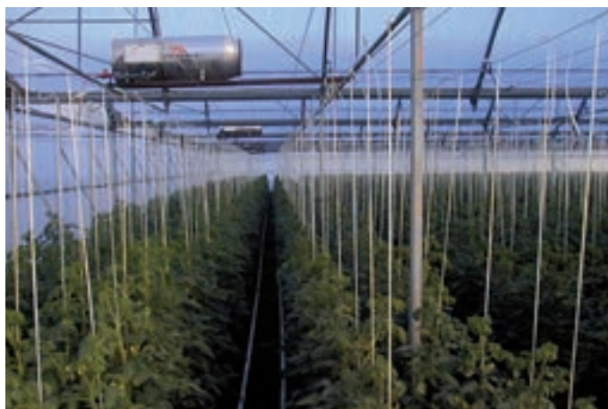
Figura 2. Sistemas con combustión directa (cañón)
