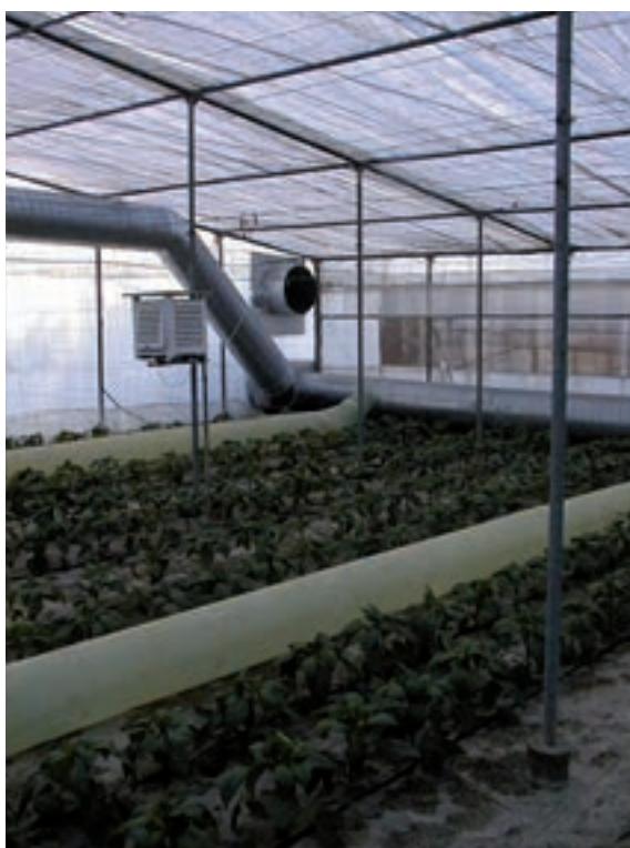
Figura 1. Distribución del calor mediante mangas perforadas de polietileno para un sistema de combustión indirecto
