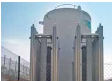
Fotografía 2.18 Detalle del intercambiador de calor empleado en el proceso de gasificación.
