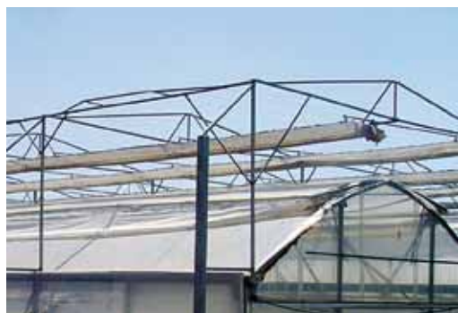
Fotografía 2.13 Vista de la estructura metálica de soporte de la pantalla de sombreo.
