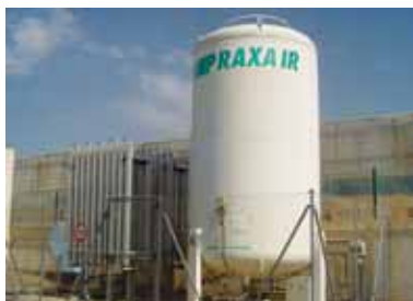
Fotografía 2.17 Vista del tanque donde se almacenaba el \text{CO}_2 licuado y del intercambiador de calor.
