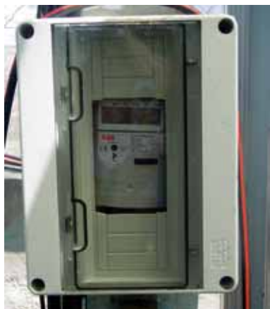
Fotografía 2.22 Detalle del contador energético de calefacción.
