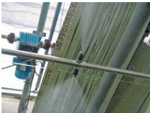
Fotografía 2.15 Detalle de dos boquillas del sistema de nebulización en funcionamiento.
