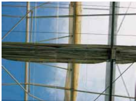
Fotografía 2.10 Vista de la pantalla interior de ahorro energético recogida .
