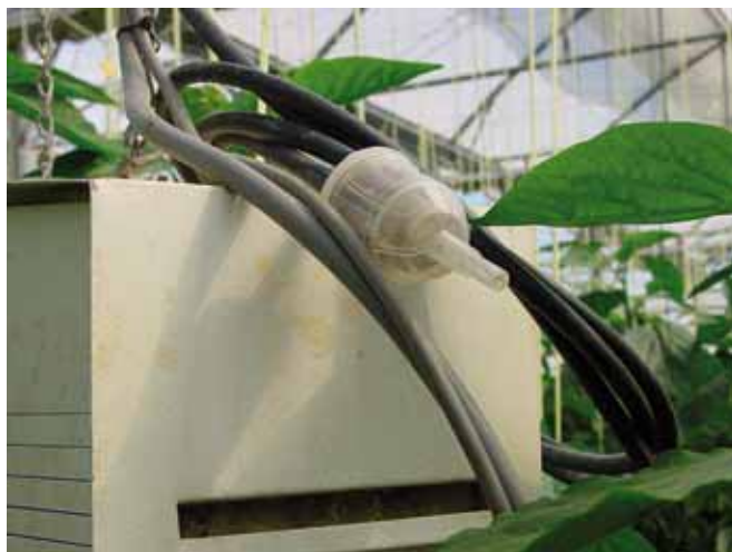
Fotografía 2.20 Detalle del filtro de aspiración.
