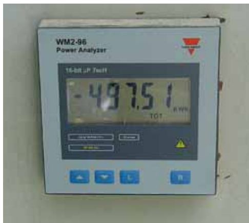
Fotografía 2.23 Detalle del contador eléctrico general.
