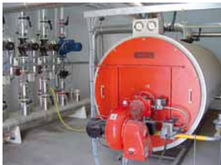
Fotografía 2.8 Vista de la sala de caldera.
