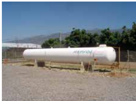
Fotografía 2.9 Vista del tanque de almacenamiento del gas propano.
