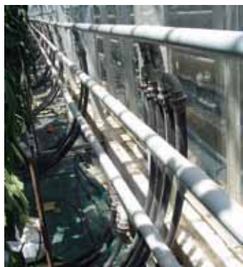
Fotografía 2.6. Detalle de las tuberías de conducción del agua procedente de la caldera y de las de retorno a la misma.
