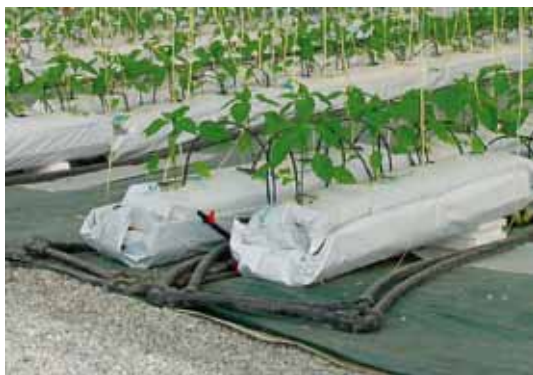
Fotografía 2.7 Vista de la distribución de las tuberías de polietileno del sistema de calefacción en una línea de cultivo.
