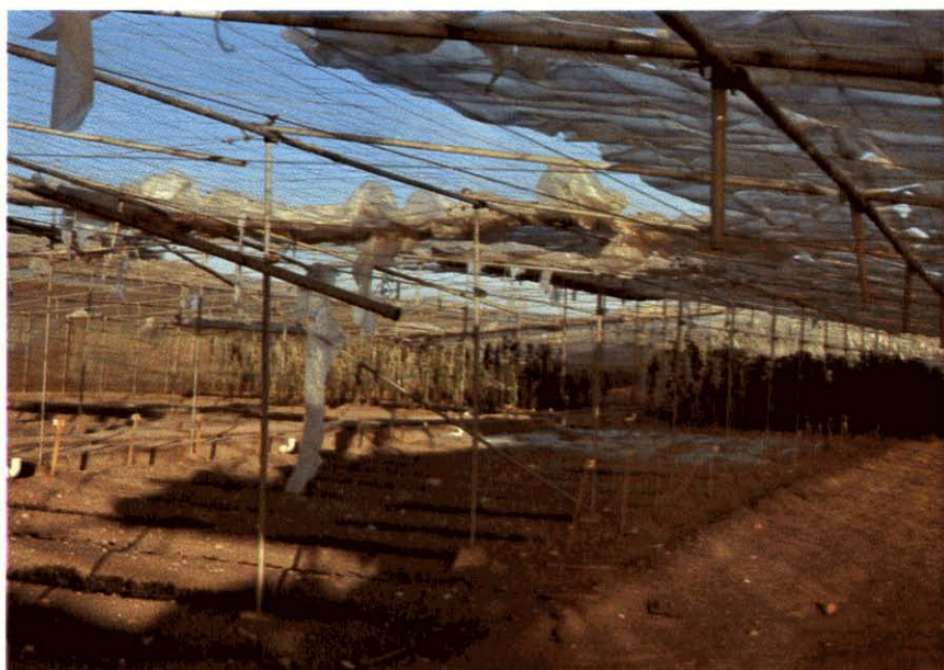
Foto 5.—El duro régimen de vientos es causa frecuente de daños en los invernaderos almerienses (daños de enero de 1978).
